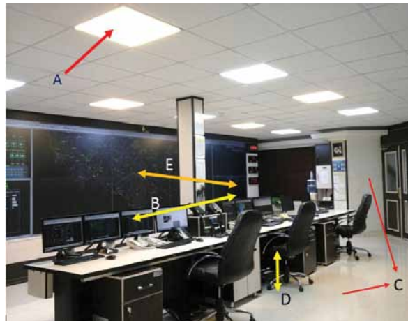
شکل ۴: نمای کلی از اتاق کنترل
