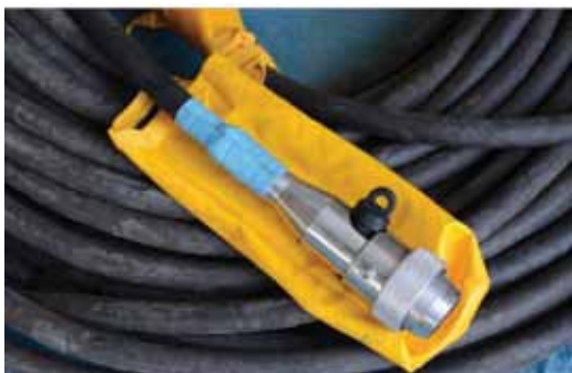
شکل ۵: کابل عملیات بای پاس
