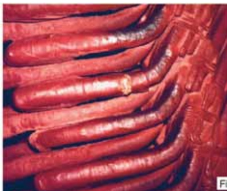
شکل (۱): آسیب‌دیدگی عایق سیم‌پیچ در اثر شیء خارجی
