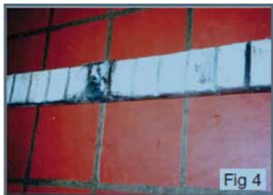
شکل (۴): تخلیه جزیی شدید بر روی سطح خارجی سیم پیچی استاتور
