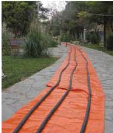
شکل ۹: کابل‌های ارتباطی پهن شده روی کفپوش مخصوص
